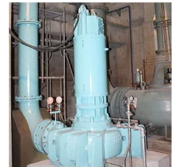
設備機器の防水化 (耐水型モーター)
